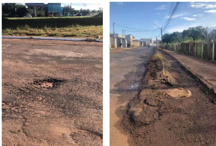
Figura 3 – Visão geral das condições do pavimento na Alameda Nestor Fonseca.
