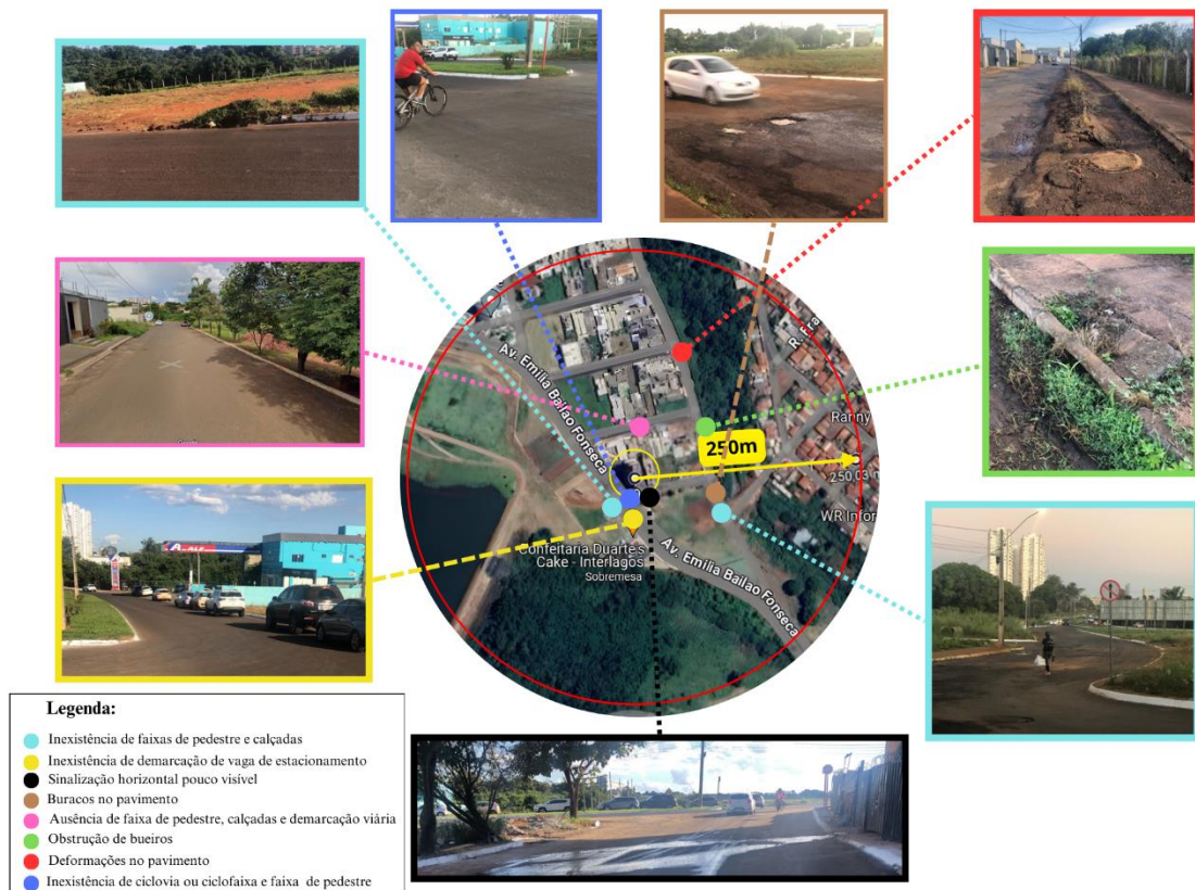
Figura 4 – Visão geral das condições do pavimento na Alameda Nestor Fonseca.
